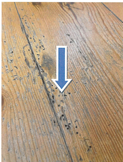
Zdj. 14 Podłoga zaatakowana przez owady. Widoczne otwory chodników owadów.
